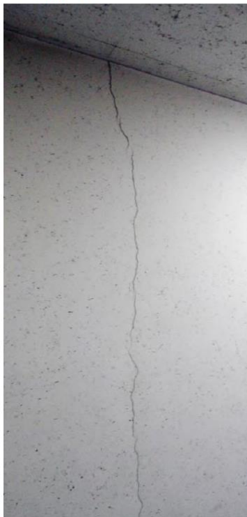
壁のひび割れ
