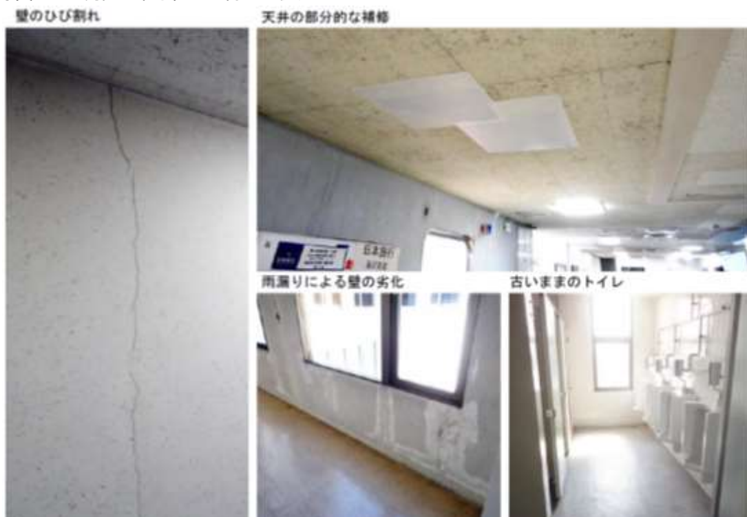
写真 1-1 現在の本庁舎の老朽化の状況
