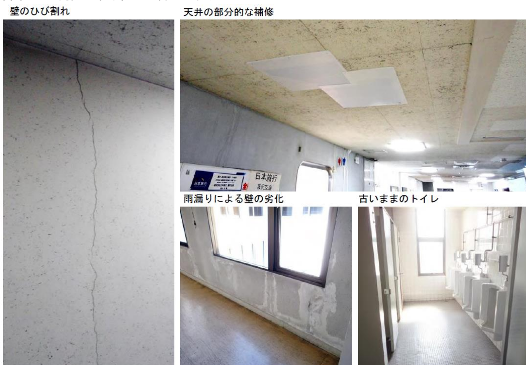
写真 1-1 現在の本庁舎の老朽化の状況
