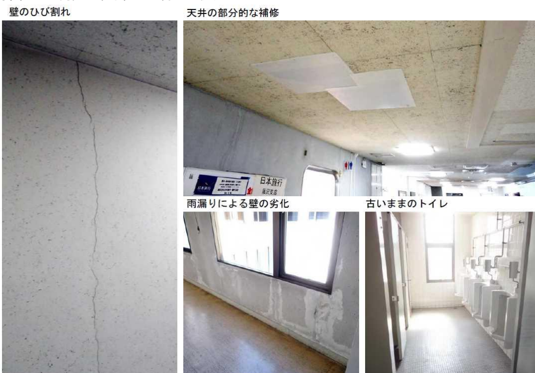
写真 1-1 現在の本庁舎の老朽化の状況
