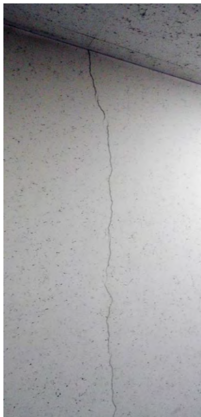
壁のひび割れ
