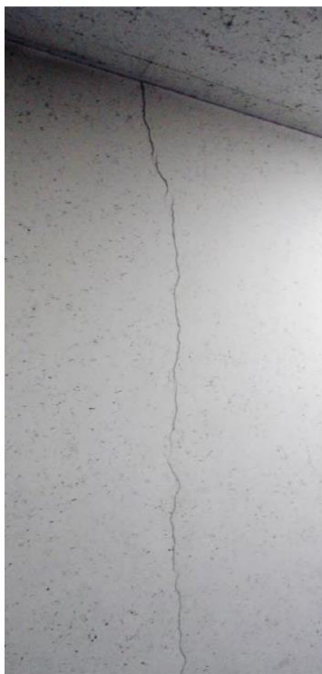
壁のひび割れ
