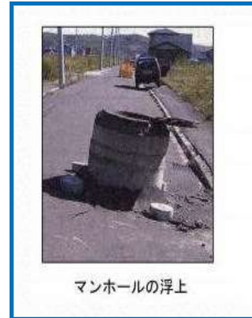
大規模地震時の被害状況写真:塩化ビニル管・継手協会資料より
