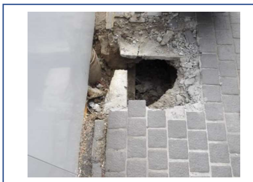
管渠破損による陥没の状況
