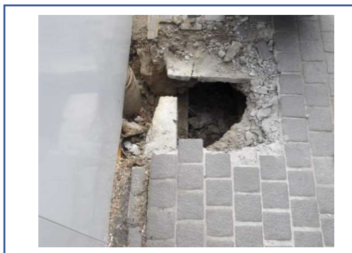
管きよ破損による陥没の状況
