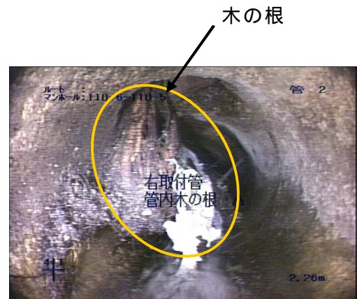
老朽化した汚水管渠 木の根が混入した例
