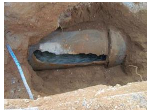
圧送管吐出し部付近の管の劣化状況 (H22年七里ガ浜圧送管)
