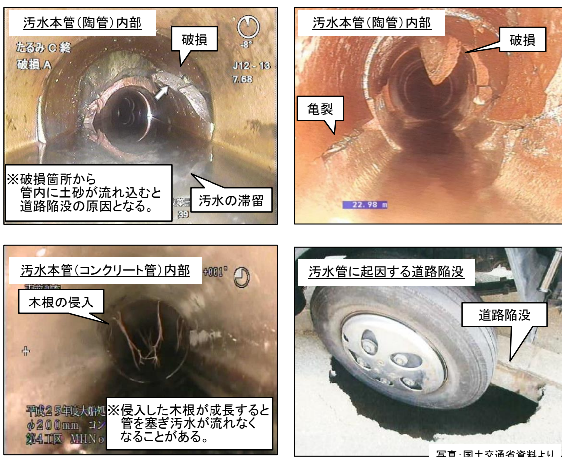
写真 污水管渠の破損状況
