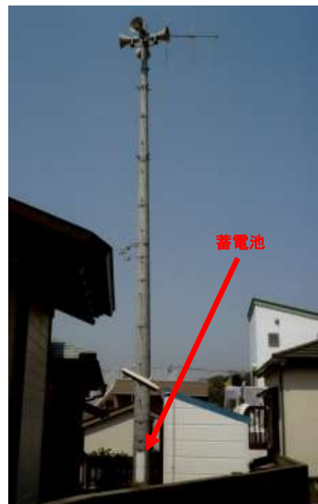
防災行政用無線(蓄電池付き)
