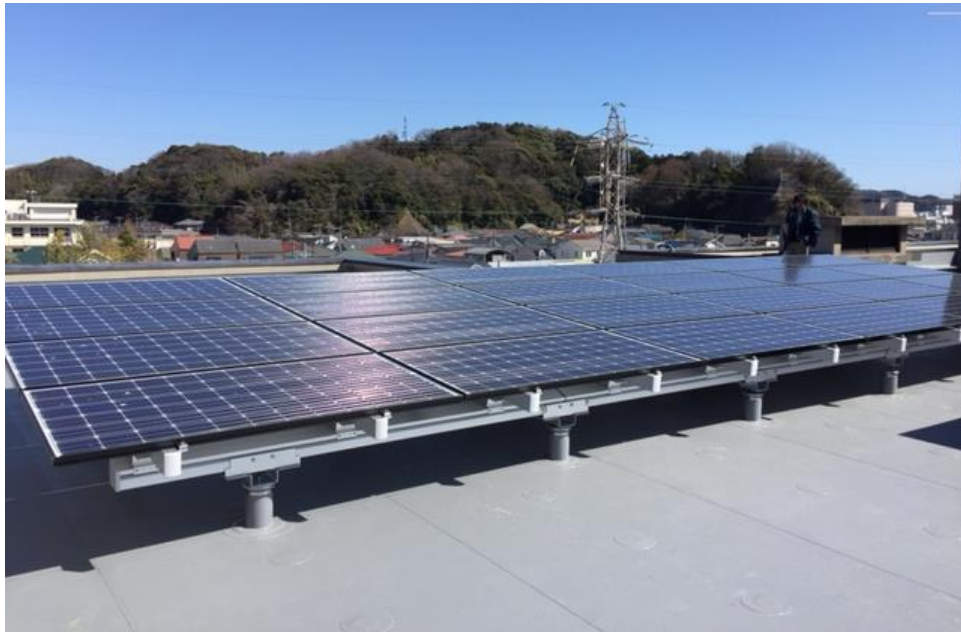
玉縄行政センター太陽光発電設備
