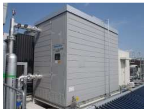
屋外仕様(湘南ビル)
