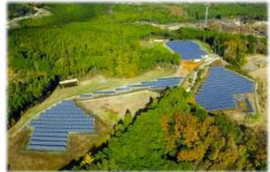
ほうとくエネルギー様太陽光発電所
