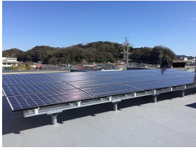
玉縄行政センター 太陽光発電設備
