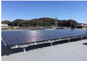
玉縄行政センター 太陽光発電設備
