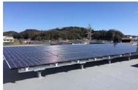
玉縄行政センター 太陽光発電設備
