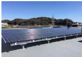
玉縄行政センター 太陽光発電設備
