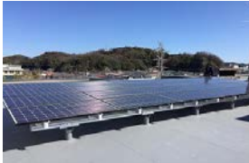
玉縄行政センター 太陽光発電設備
