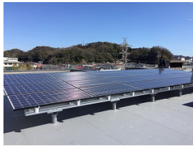
玉縄行政センター 太陽光発電設備
