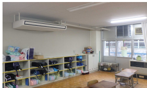
山崎小学校普通教室冷房設備
