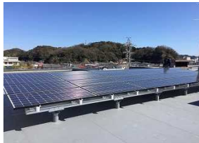
玉縄行政センター 太陽光発電設備
