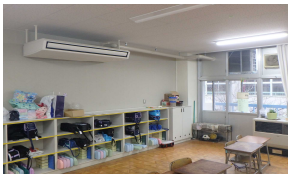
山崎小学校普通教室冷房設備
