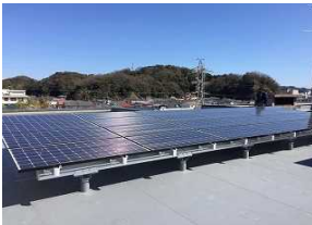
玉縄行政センター太陽光発電設備
