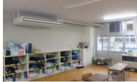
山崎小学校 普通教室冷房設備
