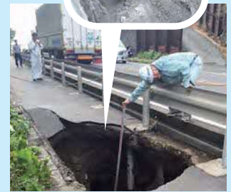
地盤沈下などで破損した汚水管(平成28年・稲村ガ崎)
