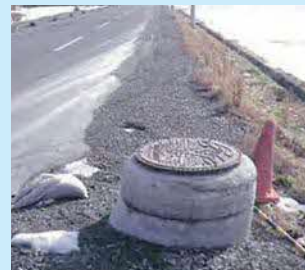
地震で浮上したマンホール(平成23年・宮城県提供)
