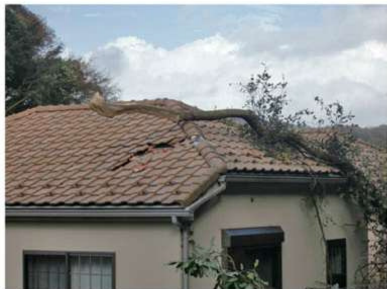
倒木による家屋への被害
