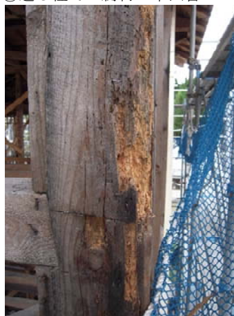
③通し柱での腐朽・甲虫害
