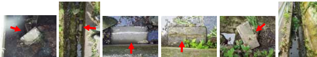
下流に流されたブロック モルタルが劣化し剥離した箇所 剥離したブロック 上流側から
