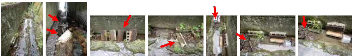
復旧作業前 橋の下からブロック5個を回収 外れたブロック 上流に小さな堰を設けて川水を排水した
