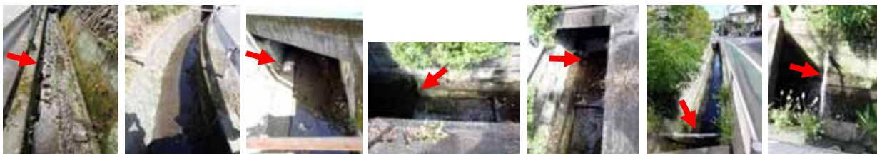
エコアップ箇所 元・うな豊の前 土嚢 右岸の洗掘箇所 泡は少ない 配管の被覆が破損したまま
