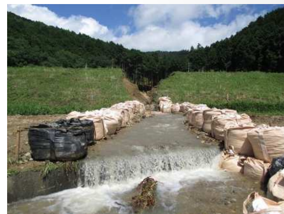
平成28年6月23日大雨 によるため池決壊
