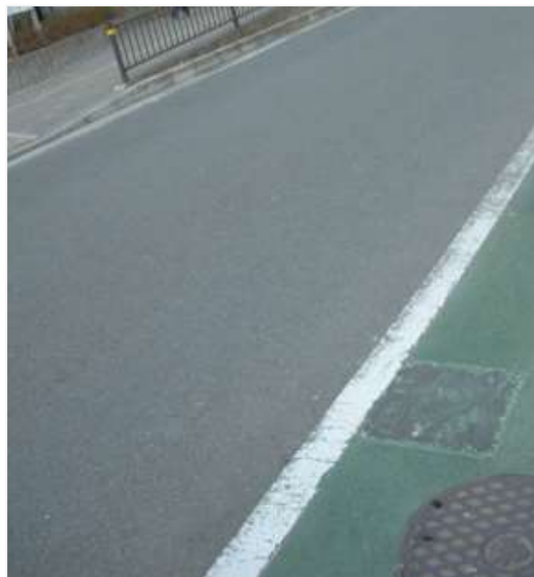
図 3.2-6 MC I = 6 ひび割れがわずかにある程度
