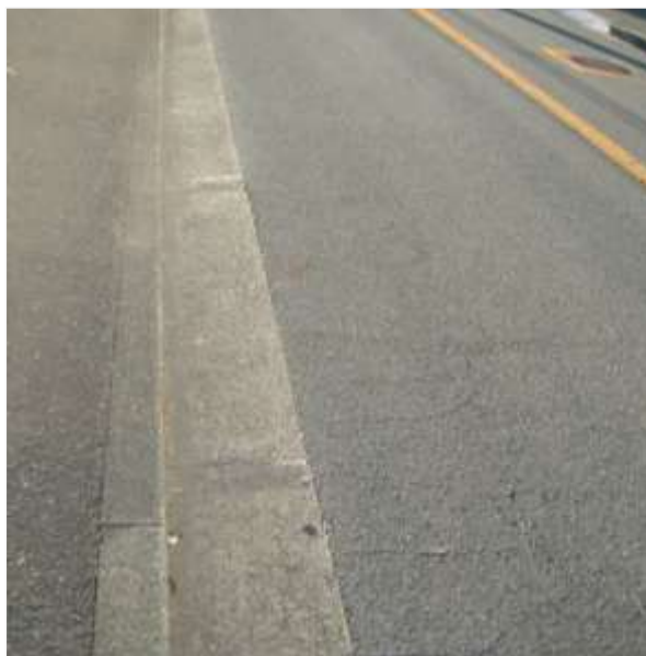
図 3.2-7 MC I = 5 ひび割れが見える程度
