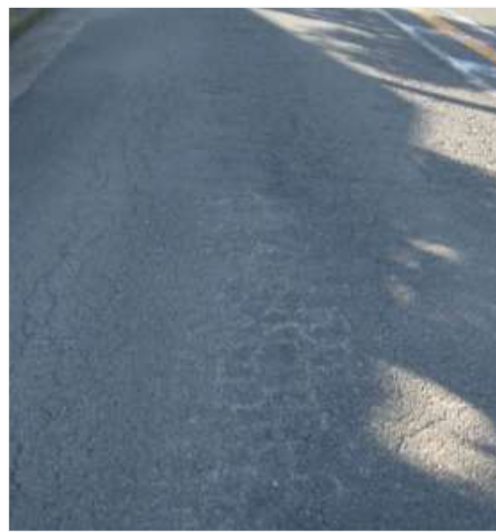
図 3.2-10 MC I = 2 ひび割れが全面にひろがり、わだち掘れが顕著
