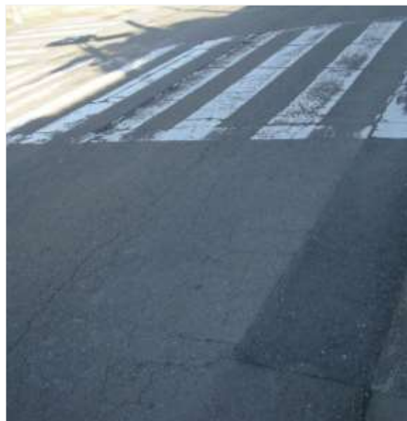
図 3.2-8 MC I = 4 ひび割れが複数ある程度
