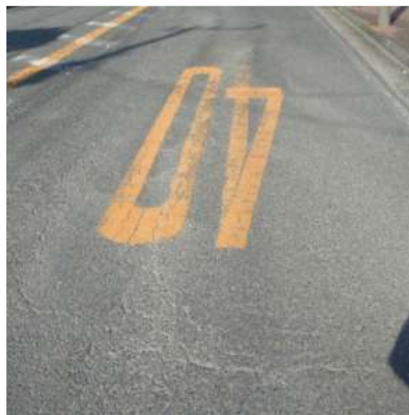
図 3.2-9 MC I = 3 ひび割れが面状にひろがり、わだち掘れがある
